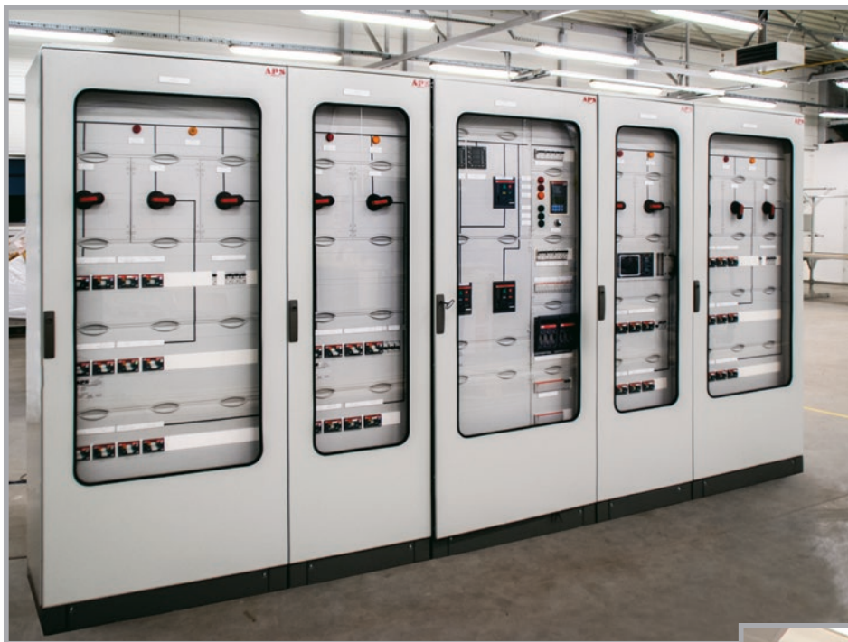
System potrzeb własnych stacji 110 kV, Rosja
