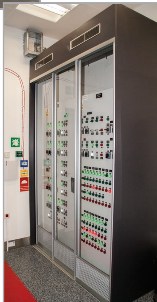
Rozdzielnica sterowania oświetleniem, Metro Warszawskie
