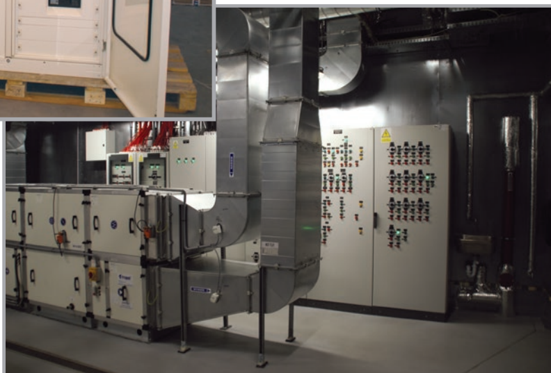
Rozdzielnica sterowania układami wentylacji, Metro Warszawskie
