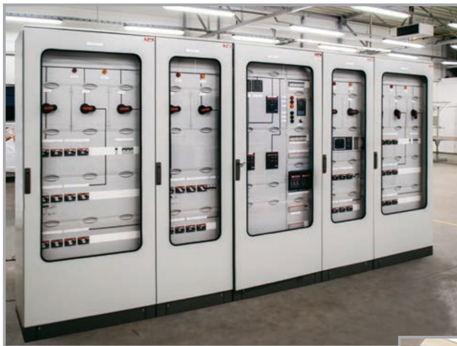
System potrzeb własnych stacji 110 kV, Rosja
