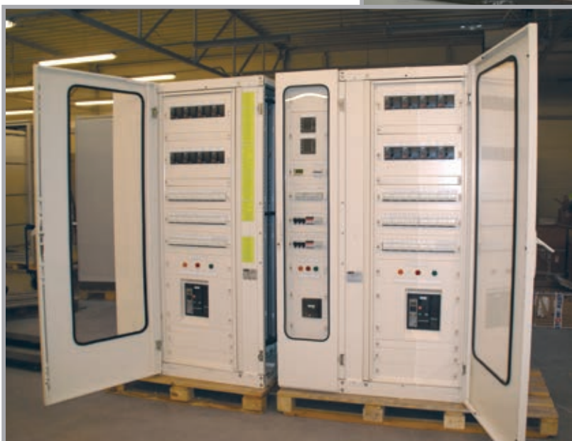
Kazachstan, System potrzeb własnych
