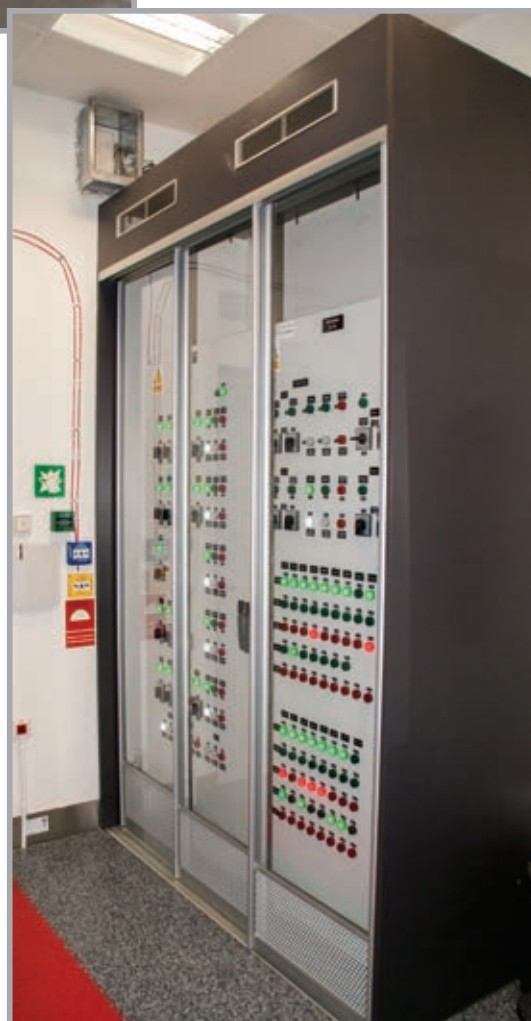
Rozdzielnica sterowania oświetleniem, Metro Warszawskie
