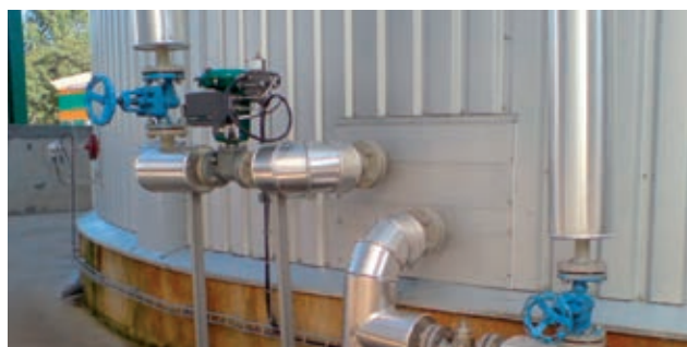
Układ regulacji temperatury (podłączenie i sprawdzenie)
